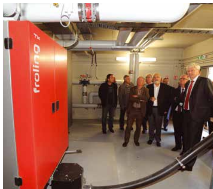
Le collège de Bouloire bénéficie de la 1 ère chaufferie à granulés bois.
